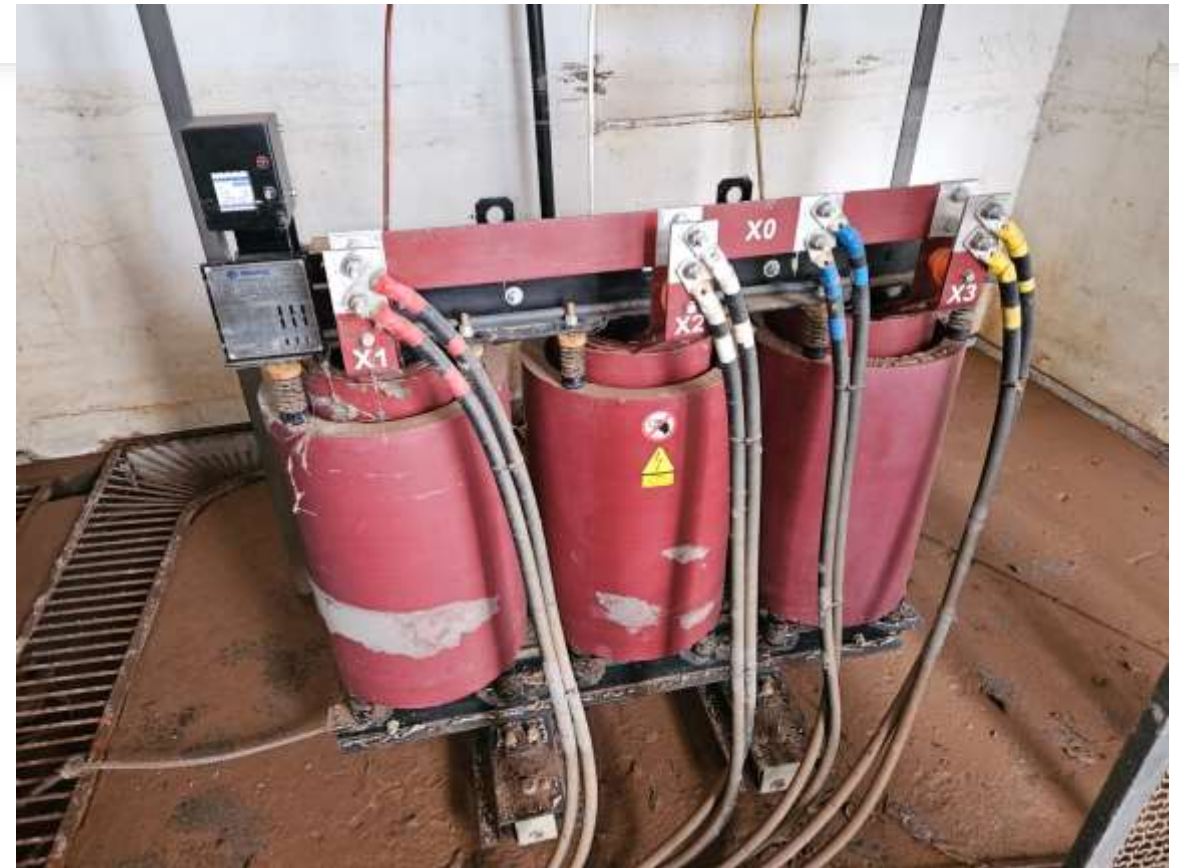
Trafo 225kVA a seco
