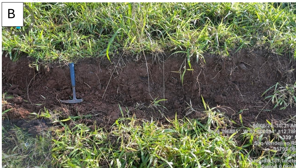
Figura 5 – Rachaduras: (a) rachadura (fenda) sem degrau; e (b) rachadura com degrau grande.
