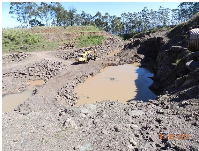
Figura 43 - Acúmulo de água na base da cava.
