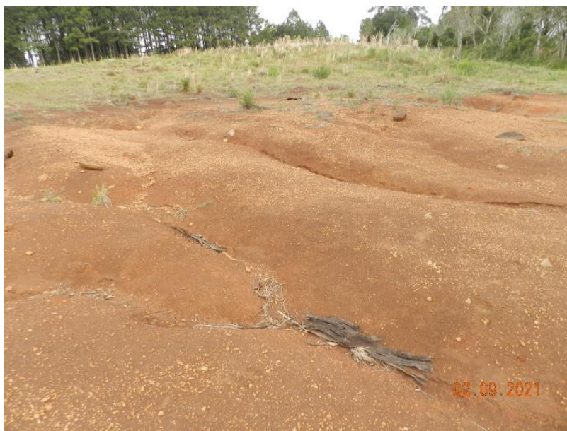
Figura 61 - Focos erosivos em sulcos em local de solo exposto.
